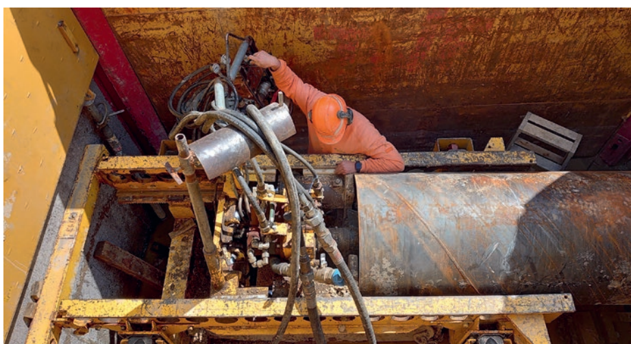
Von der Startgrube aus wird das Schutz- oder Vortriebsrohr von > 800 mm durch das Erdreich gepresst.
